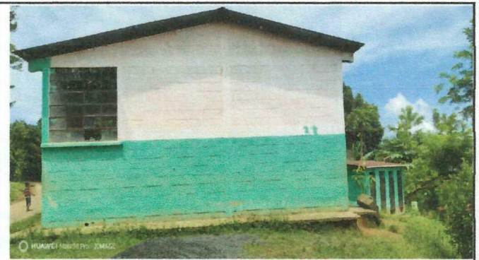
Foto 4: Paredes exteriores con visible deterioro de su pintura.
