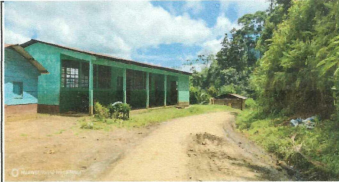
Foto1: Vista panorámica estado actual de escuela, que sufre vandalismo por estar a la orilla de la carretera.
